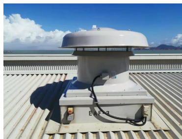
青山灣踏石角發電站
